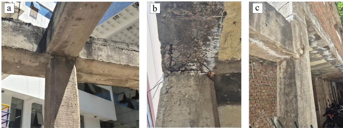
Figura 7. (a) Nudo viga–columna, (b) corrosión de armadura y (c) deterioro del hormigón.
