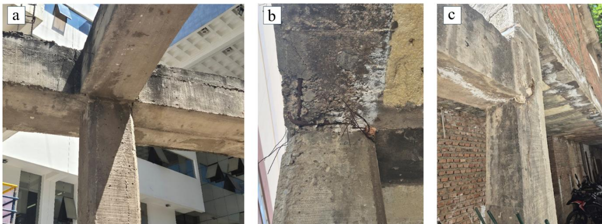
Figura 7. (a) Nó viga–pilar, (b) corrosão das armaduras e (c) deterioração do concreto.
