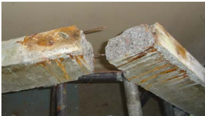
Figura 4. Viga V96 luego del colapso.
