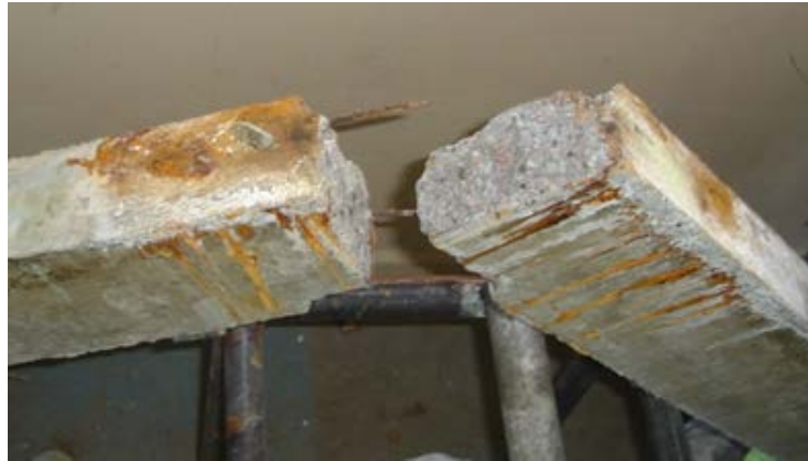
Figura 4. Viga V96 após o colapso.
