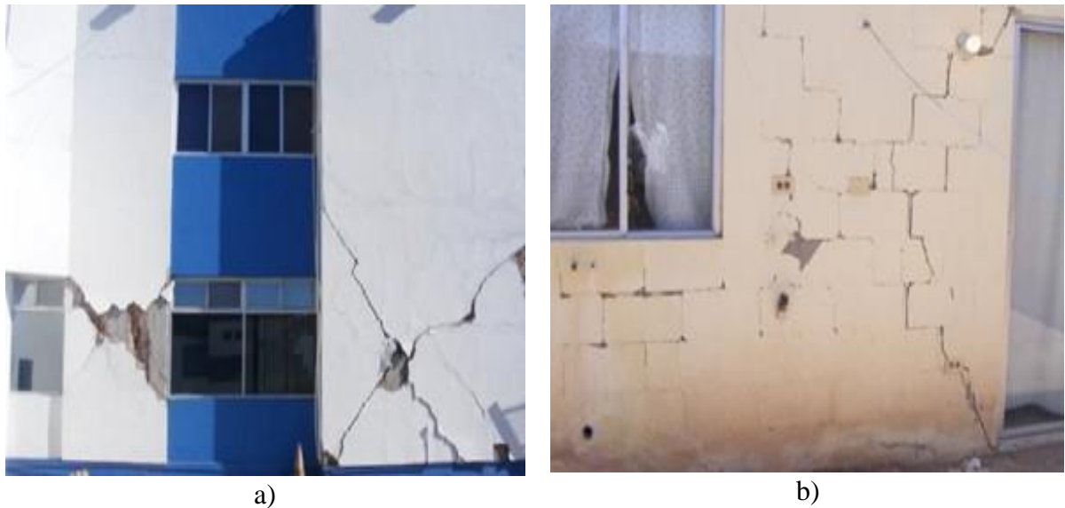
Figura 1. Daños en muros de mampostería en el sismo de Mexicali, Baja California (Martínez y Martínez, 2010): a) Muros cortos perimetrales, b) Casa-habitación
