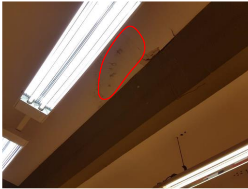
Figura 7. Manchas de umidade no teto em destaque
