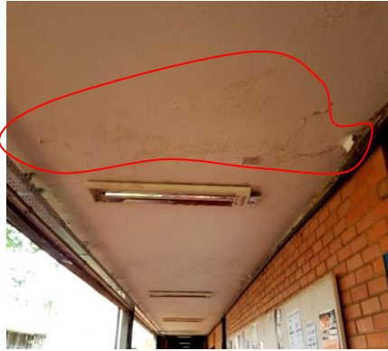
Figura 3. Goteiras no forro do teto do corredor com bolor, manchas de umidade e descascamento do revestimento.
