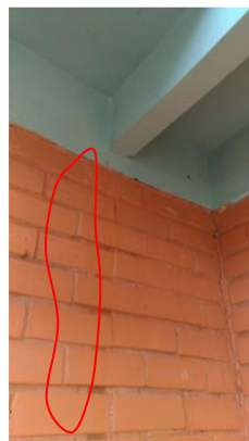
Figura 5. Escorrimento de água na interface viga-alvenaria
