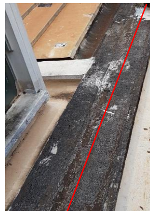
Figura 6. Junta estrutural sem selante
