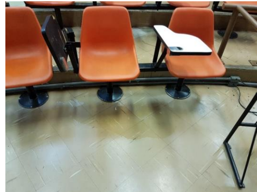
Figura 8. Poças de água formadas pela goteira
