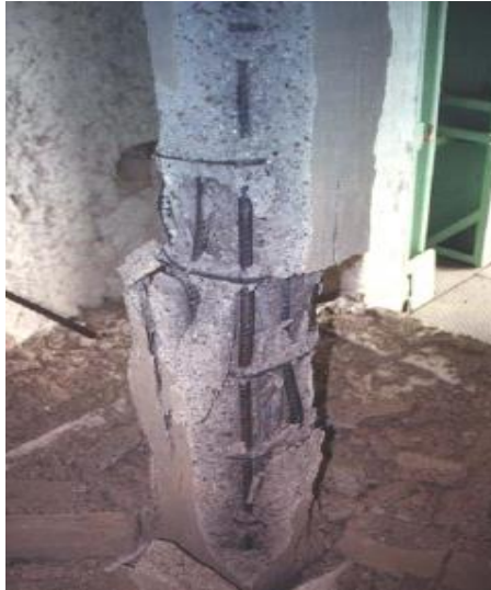
Figura 10. Ejemplo de spalling explosivo en pilares de concreto de alta resistencia. f_{ck} = 83 MPa (Kodur et al., 2005).
