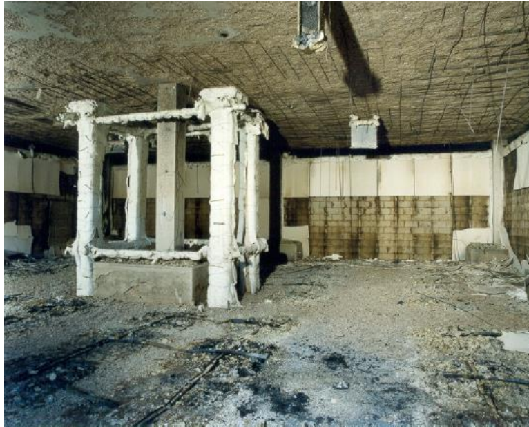
Figura 18. Detalle de la extensión y severidad del spalling de la losa ( f_{ck} = 74 MPa) después de la simulación de incendio. Resaltando, observe las condiciones de integridad del pilar de concreto de alta resistencia ( f_{ck} = 103 MPa) (Chana & Price, 2003).
