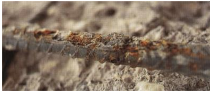
Figura 5. Corrosión típica inducida por picaduras de cloruro.
