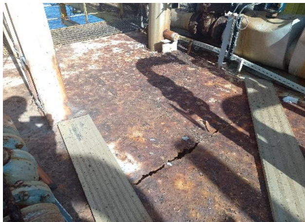
Figura 10. Efeitos da corrosão em pisos e vigas metálicas.
