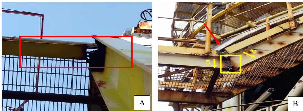
Figura 11. Ruptura por corrosão na interseção viga - coluna (A) e viga - viga (B).
