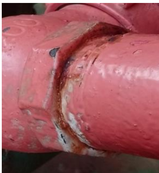
Figura 2. Corrosão em fresta de ligação rosqueada de uma linha de incêndio.
