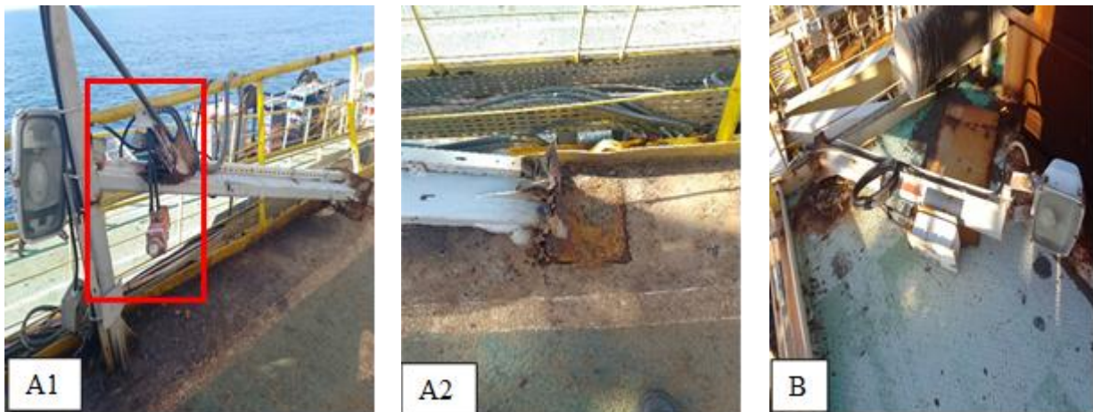
Figura 3. Colapsos pela corrosão da base de postes de iluminação metálicos.
