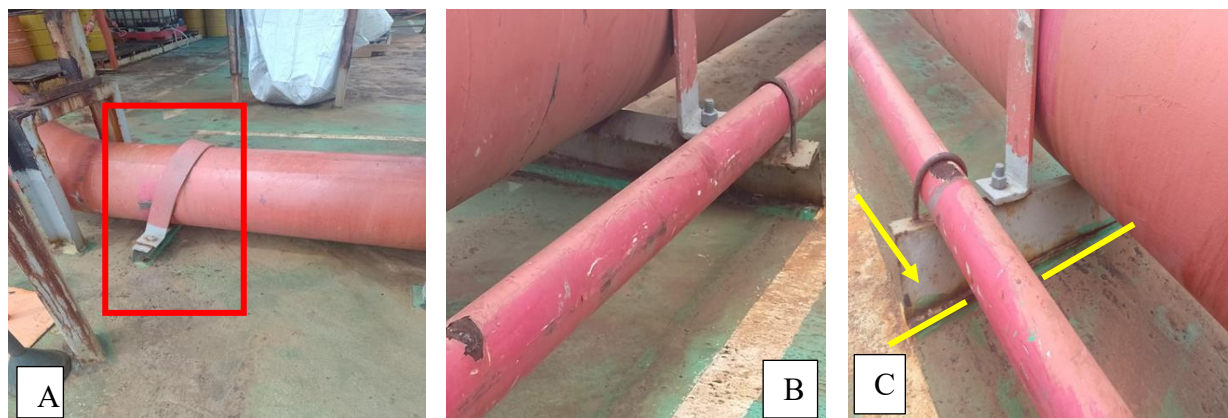
Figura 5. Deformação e trinca em perfil metálico.
