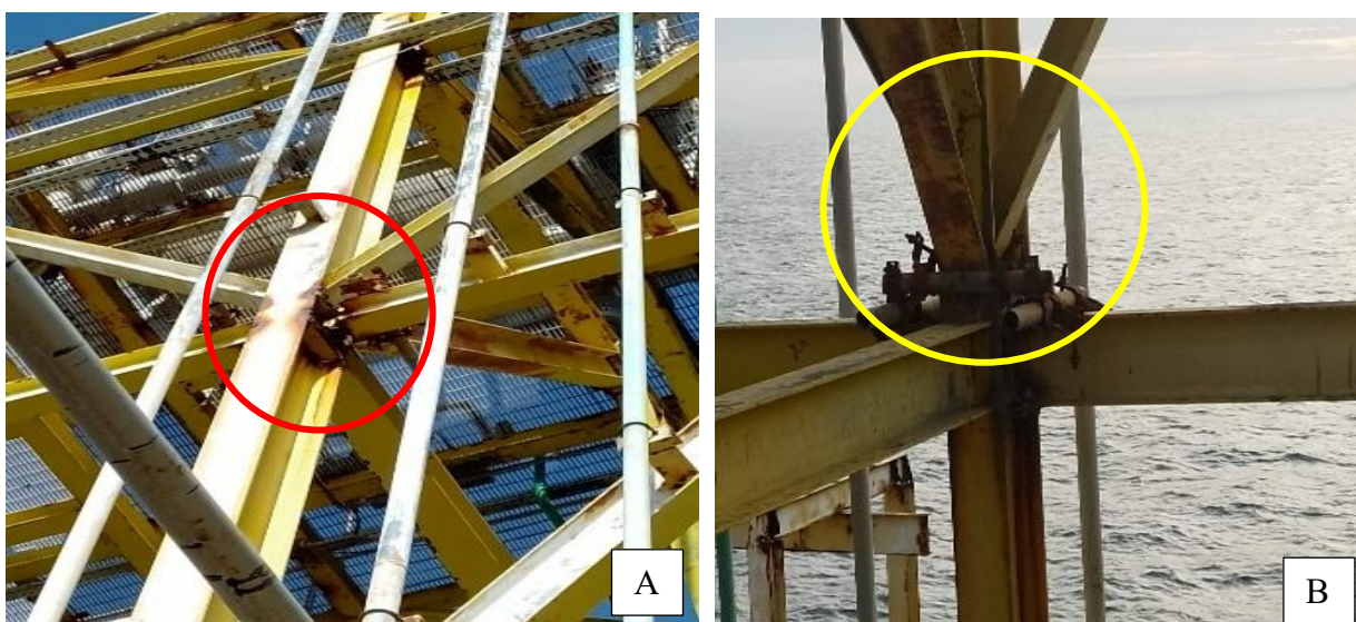
Figura 9. Falha local no nó da treliça espacial por perda de massa excessiva, causada por processo corrosivo.
