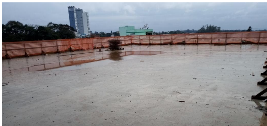
Figura 4. Acumulación de agua sobre la losa de cubierta del auditorio.
