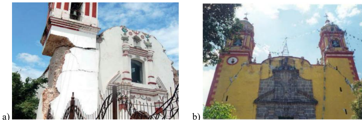
Fig. 1. Tendência de deterioração e falha em torres sineiras fixadas a corpos adjacentes; a) falha horizontal devido a terremoto com tendência a tombar no topo devido à mudança abrupta de volume. Imagem obtida do Ministério da Cultura, Governo do México. (2024), b) falha diagonal devido a um terremoto pela mudança abrupta de seção. Imagem retirada de: De la Torre RO, et. al. (2004).
