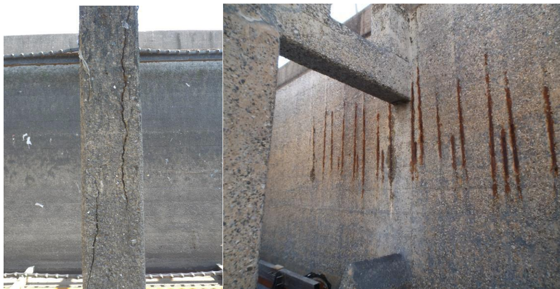
Figura 1. Columnas de concreto fisuradas, con reparaciones. Armaduras expuestas y corroídas.
